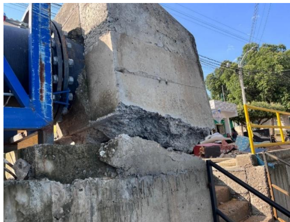
ESTADO ACTUAL DEL CODO
